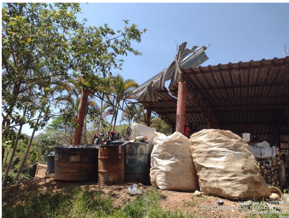
Figura 15. Parte da cobertura do galpão de triagem arruinada.
