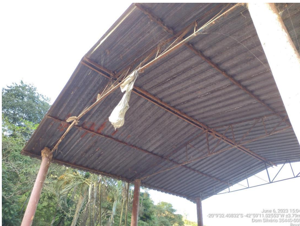
Figura 12. Cobertura a reformar, acima do galpão de triagem, onde ocorro o despejo dos resíduos sólidos urbanos.
